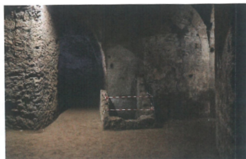
Fig. 9 - Uno dei pozzi parzialmente crollati, appoggiato per un lato su un pilastro dell'acquedotto romano.
